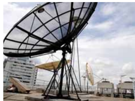
Foto Pedoman 4. Salah Satu Peralatan untuk Komunikasi Real Time yang Menjadi Tulang Punggung Sistem Peringatan Dini Tsunami.
